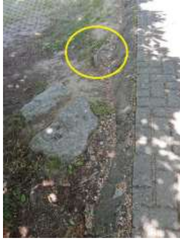
Abb.gefp004.26 - Im Bereich des Betons Wurzeln
