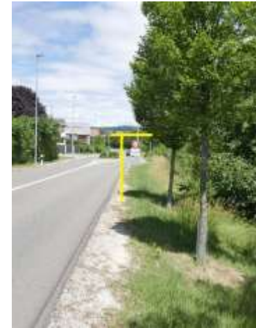
Abb.gefb007/008.04 - Lichtraumprofil strassenseitig zu tief
