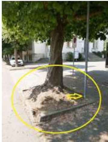
Abb.gefs001.30 - Ungenügend grosse Baumscheiben, entstehende Wurzelstockanhebung, Kandelaber Fundament in der Baumscheibe
