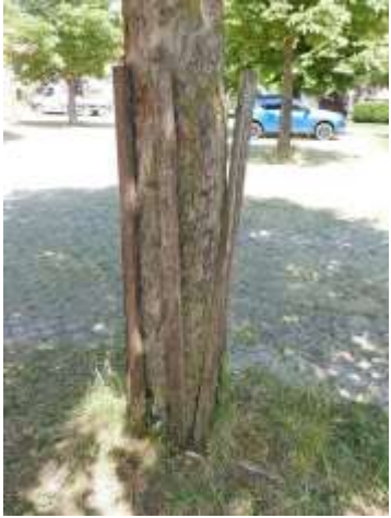
Abb.gefp002-008.25 - Stammschutz Befestigungsdrähte durch Spannung gerissen
