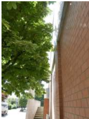
Abb.gefs005/006.38 - Baumkrone sehr nah am Gebäude, regelmässiger Schnitt notwendig
